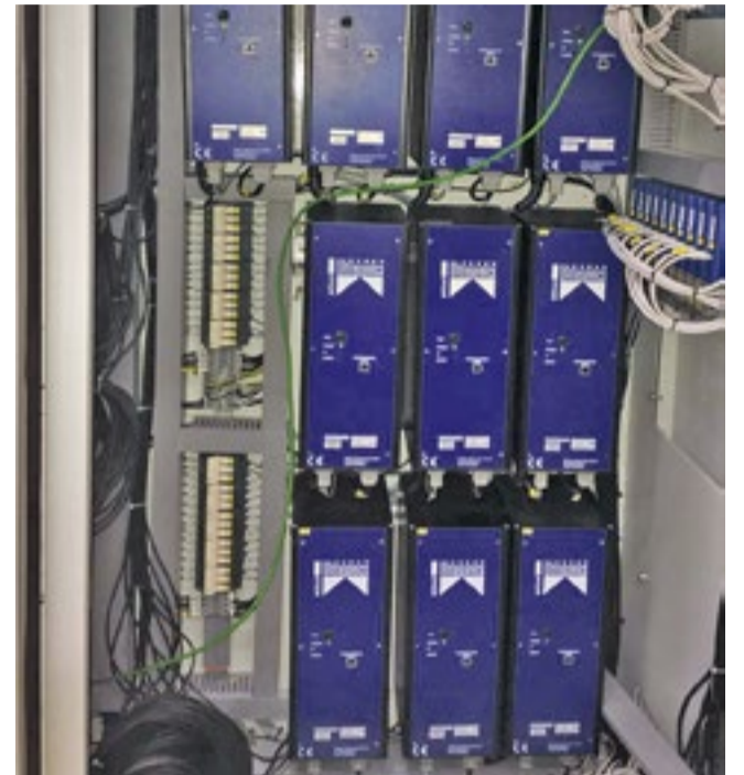
Die Anlage ist mit zehn Ultraschallsystemen ausgestattet, die für den Dauerbetrieb ausgelegt sind. Foto: Weber Ultrasonics
